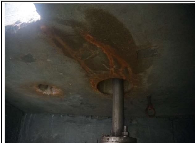
1지 유입밸브실 상부슬래브 누수흔적
