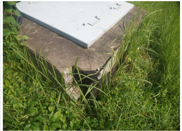
1지 유출밸브실 상부슬래브 상면 파손(모르타르)
