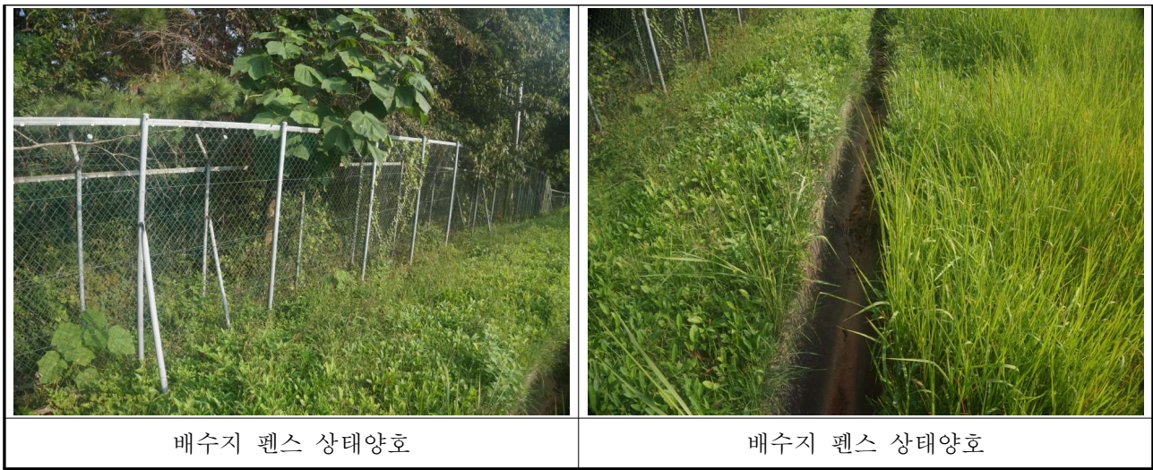
【사진 3.8】 기타 부대시설 손상사진(계속)
