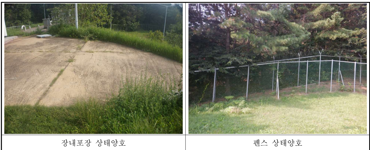
【사진 3.8】 기타 부대시설 손상사진
