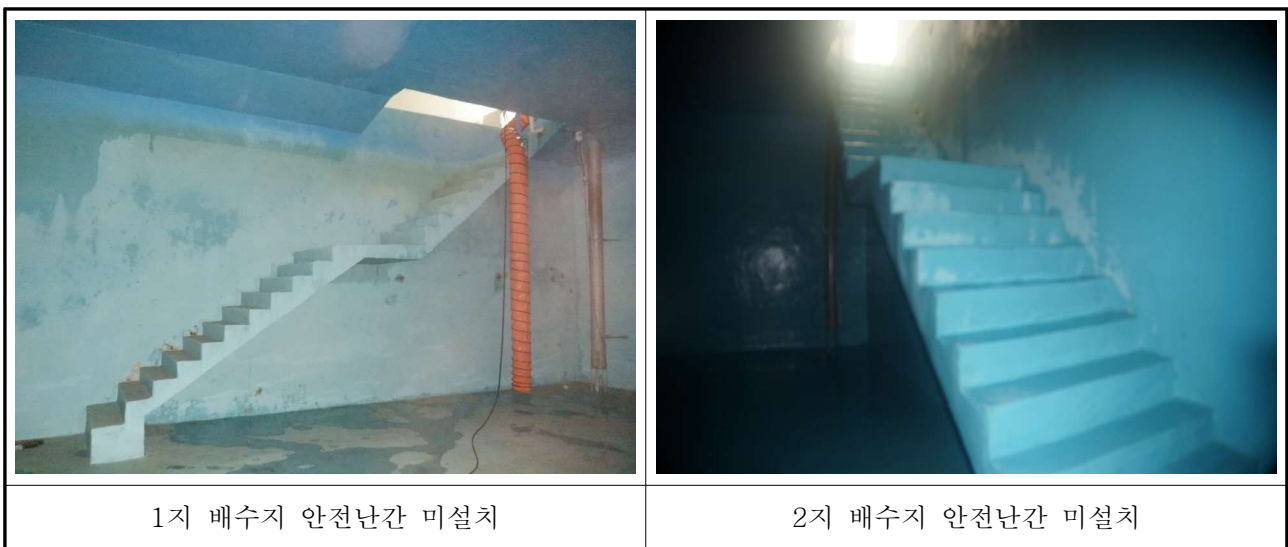
【사진 3.9】 추락방지시설 손상사진
