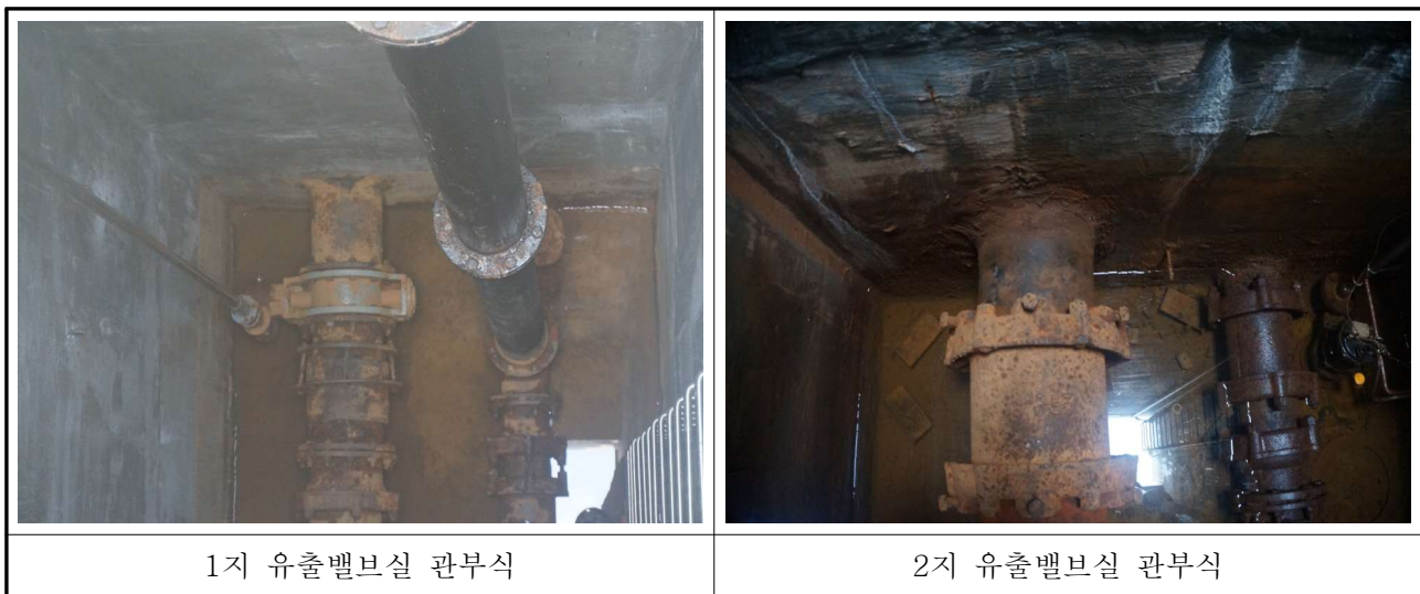
【사진 3.6】 기전설비 손상사진(계속)
