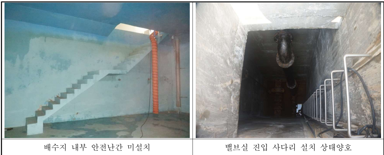
【사진 3.7】 안전시설(점검로) 손상사진
